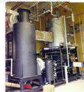
◆蒸気ボイラ(4基)
