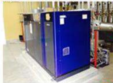
◆蒸気コンプレッサ(1基:75KW)
